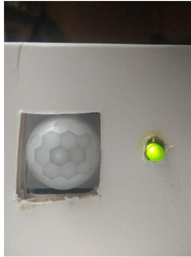
Rajah 5.6 Lampu LED3 dan PIR3 berfungsi
