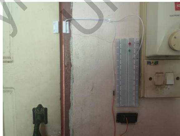
Rajah 2 Pemasangan Perkakasan Sistem ( Magnetic Door Sensor )
